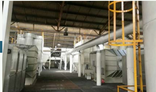
廢氣處理設備
